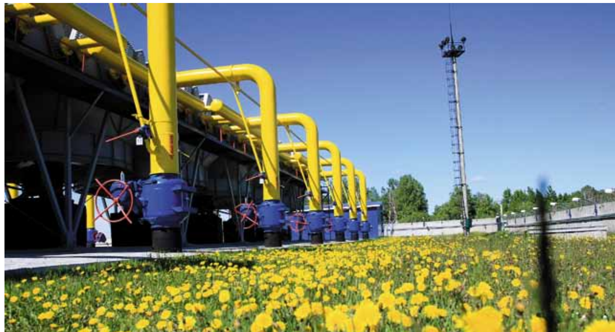
КС-3 «Кожурлинская» — первая новая компрессорная станция «Газпром трансгаз Томск» после ввода НГПЗ — Парабель — Кузбасс
