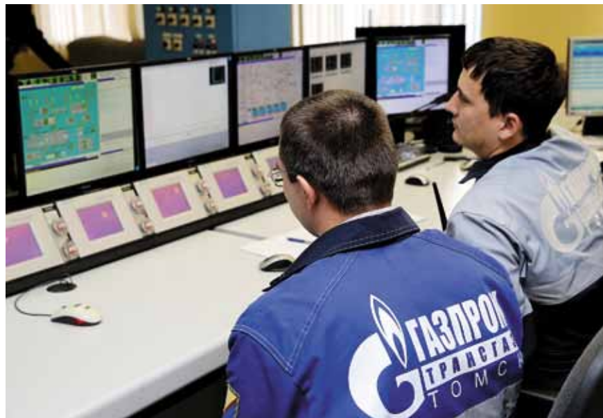
В работе КС «Кожурлинская» применяются автоматические системы управления и телемеханики, что делает её одной из самых современных компрессорных станций Западной Сибири
