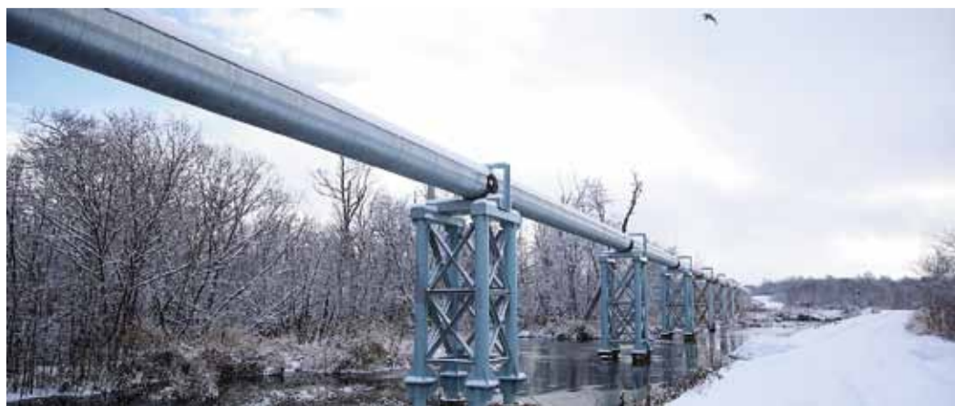
Газопровод на Камчатке способен выдержать сильные землетрясения
