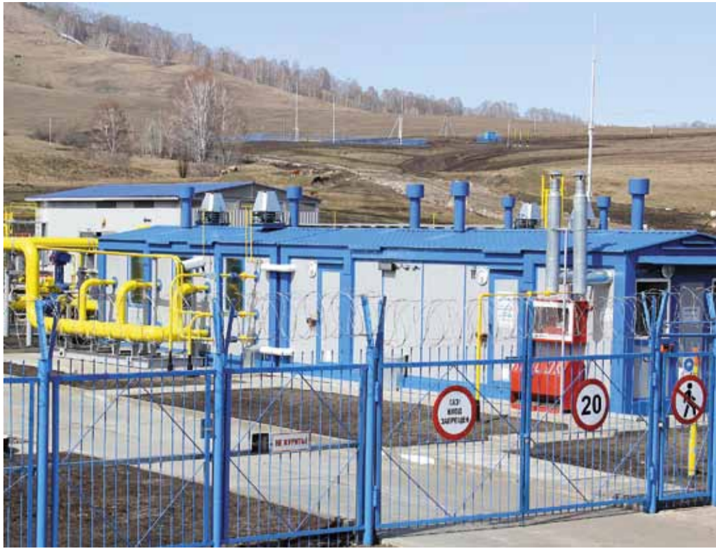
Такими станут ГРС после капитального ремонта. На снимке — ГРС «Нежнекаянча» (Алтайское ЛПУМГ)
