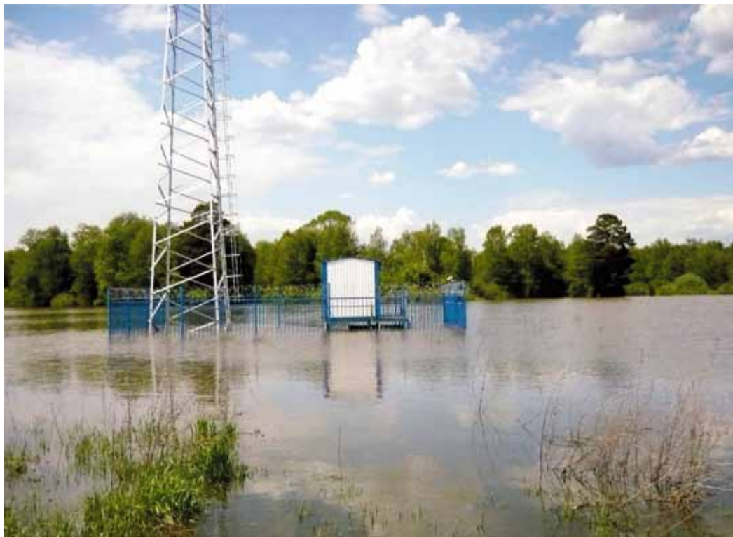
Во избежание повреждения оборудования от стихийных бедствий предусмотрена установка средств ЭХЗ на площадках высотой более 1 метра
