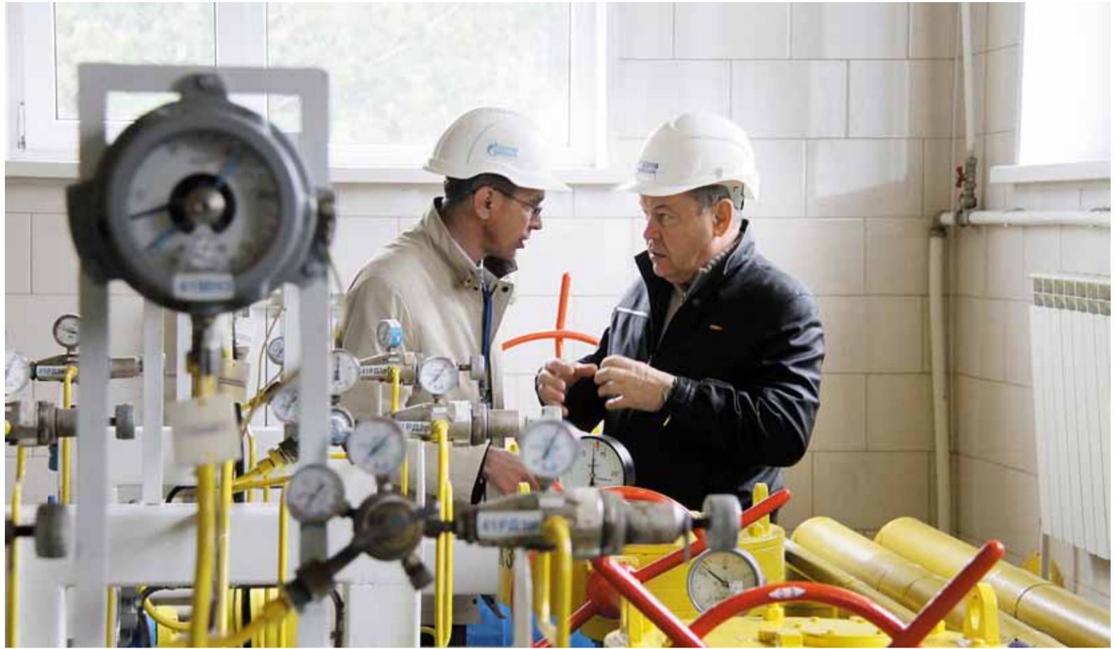
На промышленной площадке Александровского ЛПУМГ в Нижневартовске
