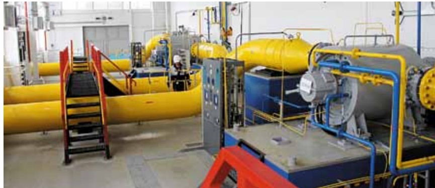
Так выглядят обновленные цеха на компрессорных станциях
