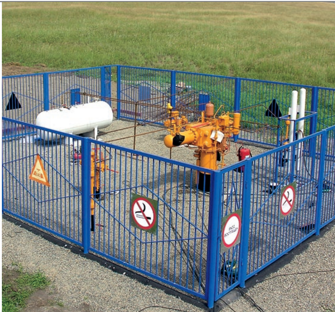
↑ Каждый крановый узел в Обществе оборудован системами телемеханики
