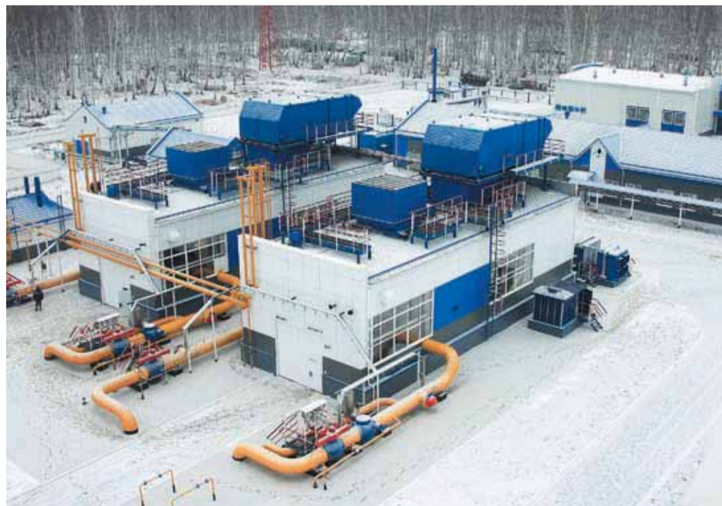
Газоперекачивающие агрегаты КС «Омская» способны перекачивать газ в любом направлении, и с востока на запад, и с запада на восток
